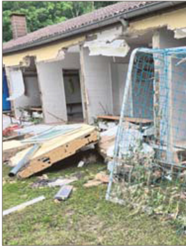
Das Vereins- und Duschgebäude in Wißmannsdorf nach der Flut. Foto: DJK
